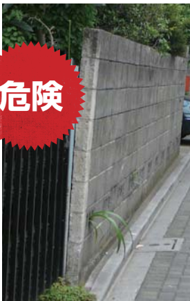
傾いている危ない塀
