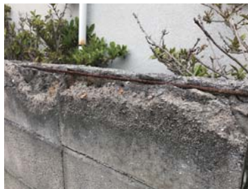
割れや鉄筋の露出がみられる塀
