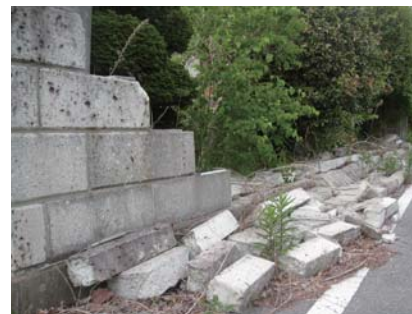
地震により石塀が倒壊
