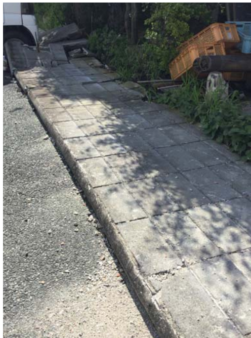
地震によりブロック塀が倒壊
